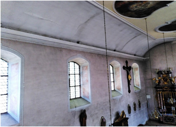
Vergrauung und Risse
